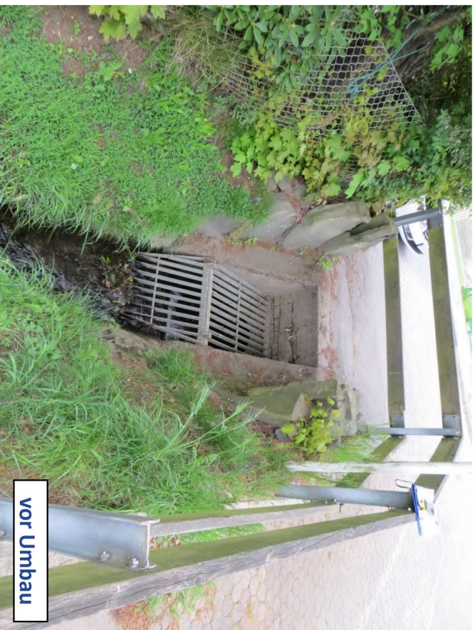
Umgestaltung Einlaufrechen zur Verringerung von Verklausungen (© Stadt Kassel)
